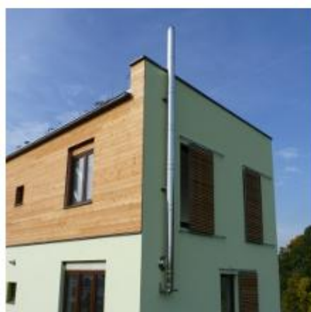
Fasádní nerezový komín na novostavbě
