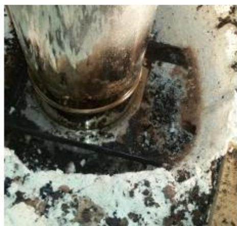
Následek chybně zaizolovaného prostupu komínu stropem
