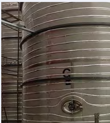
Technologický ohřev kapaliny, Rumunsko
