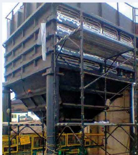
Protimrazová ochrana zásobníku, Bulharsko
