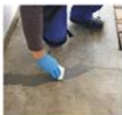
Zatmelte praskliny v betonu
