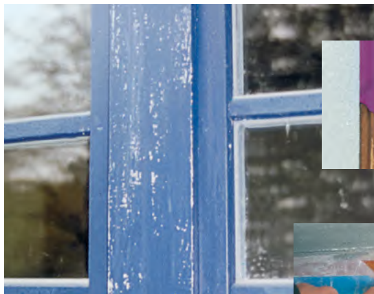
Nátěr praská po použití akrylových barev, které nestačily zaschnout.
