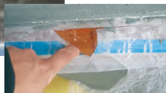
Poškozené dřevo po omítání. Důvod: Maskování s příliš slabou fólií.
