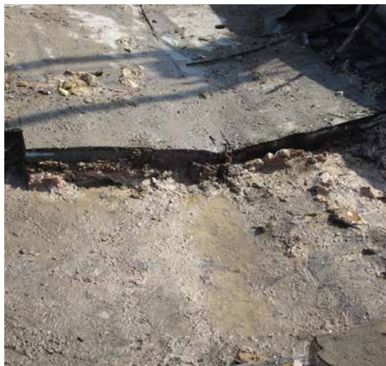
Množství zkondenzované vlhkosti ve střešní skladbě může být extrémně velké
